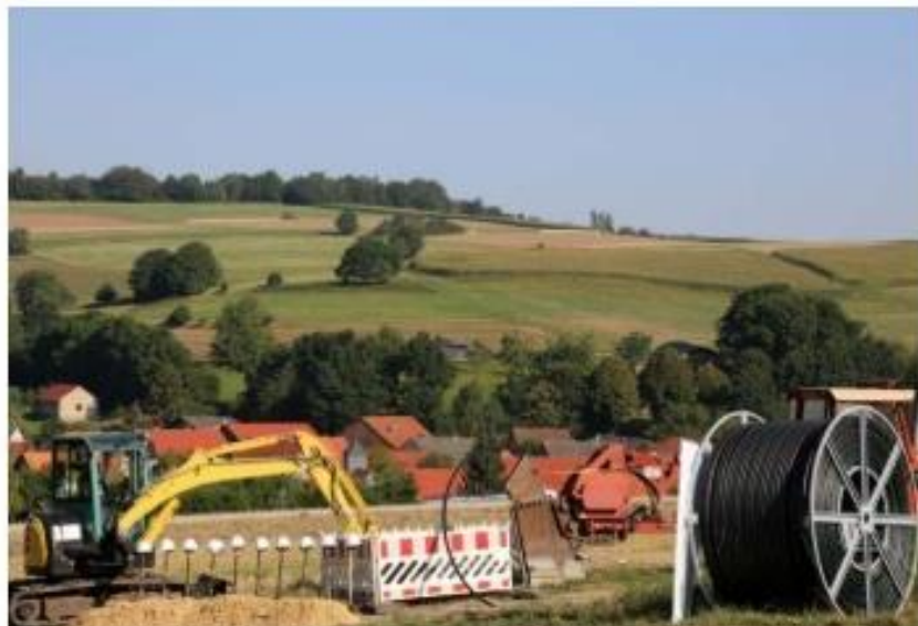
Kommunen sollten Tiefbauarbeiten nutzen, um Leerrohrinfrastrukturen für den Glasfaserbau mitzuverlegen und so Bauaktivitäten zu reduzieren, empfiehlt BUGLAS.
